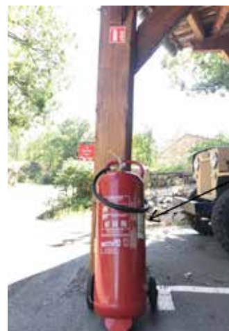
Extincteur 50L situé sous le auvent véhicules
